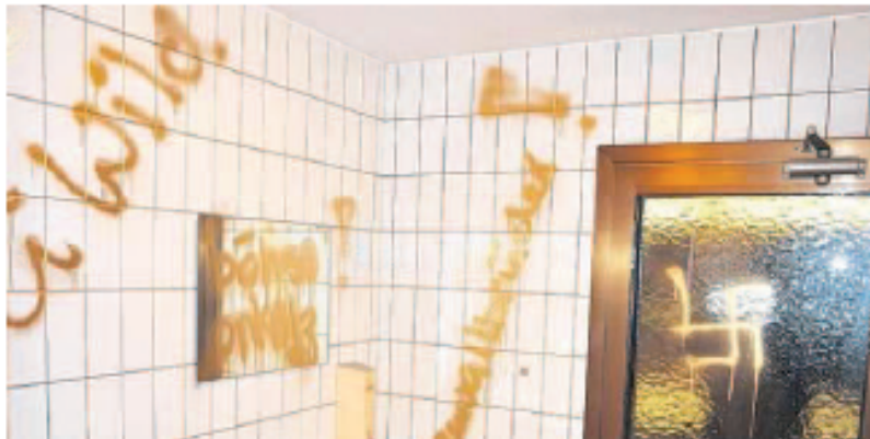
Sachbeschädigung: Die Jugendlichen verunstalteten im Dezember vergangenen Jahres unter anderem eine WC-Anlage in Nendeln. Bild Archiv
